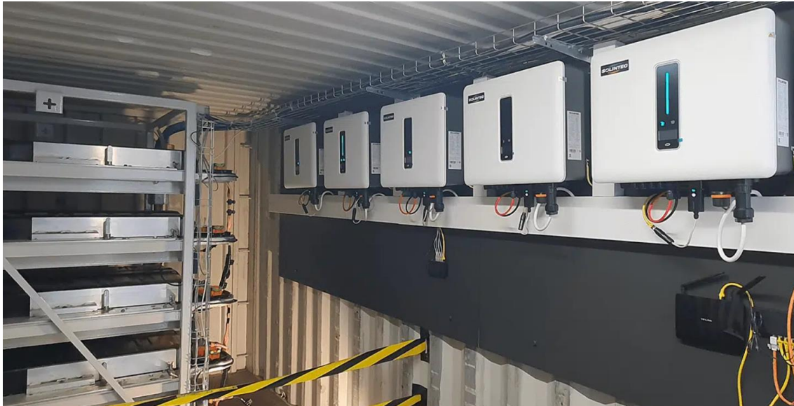
Abbildung 37: Beispiel für einen Second-Life Energiespeicher aus alten EV-Batterien (Krummenacher 2024)
