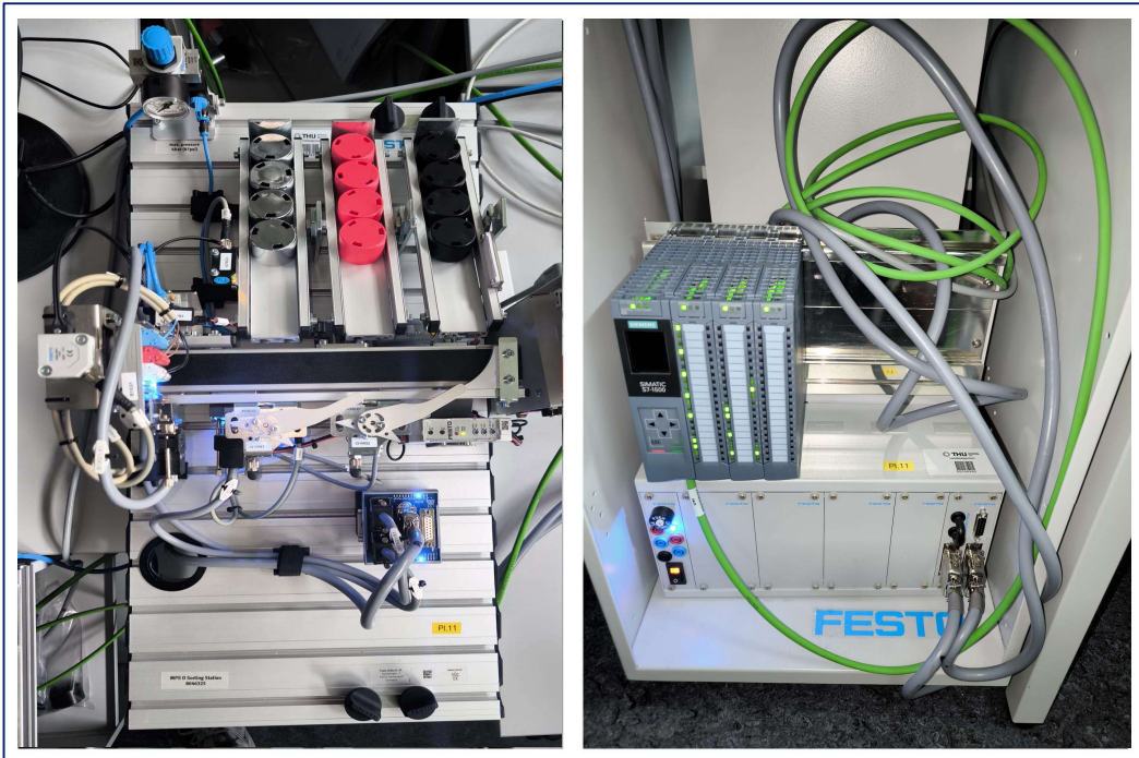
Abbildung 11: Festo MPS-Station Sortieren im Automatisierungslabor der Technischen Hochschule Ulm
